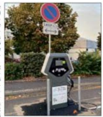
RECHARGE. Une borne publique de TE63, pour recharger.
