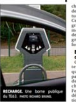
RECHARGE. Une borne publique de TE63, pour recharger.
